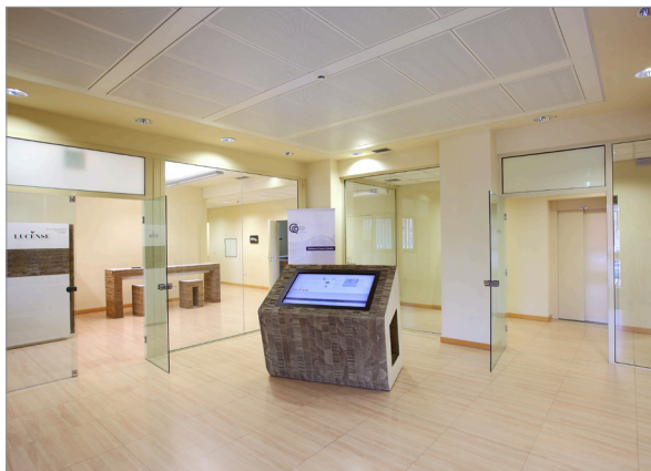
Realização com tetos radiantes metálicos
